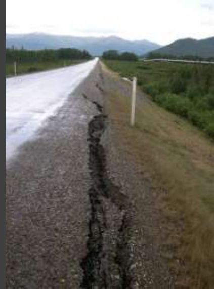
Dégradation des épaulements
